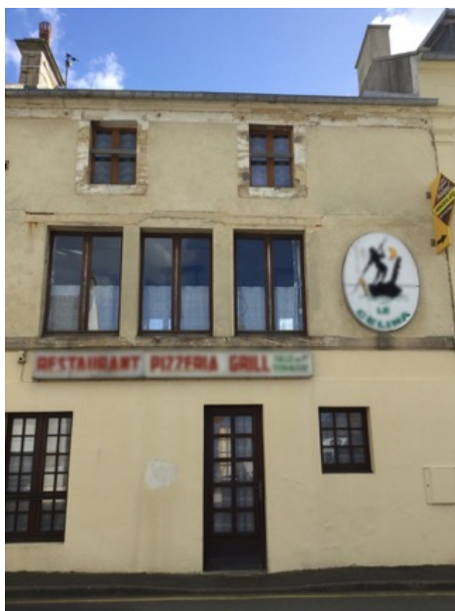
Enseigne en mauvais état d'entretien, Arromanches, 2018
